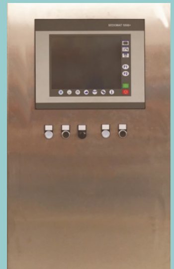
Schaltschrank mit Steuerung
